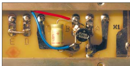
Blick in den Anschlusskasten Foto: DL2QZ
